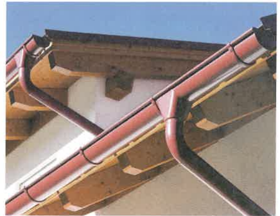
Ein funktionierendes Dachentwässerungssystem ist das A und O, um bei Starkregen zuverlässig und sicher geschützt zu sein. Prefa
